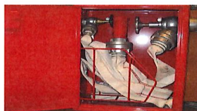
Rys. 9. Hydrant z wężem płaskoskładanym
